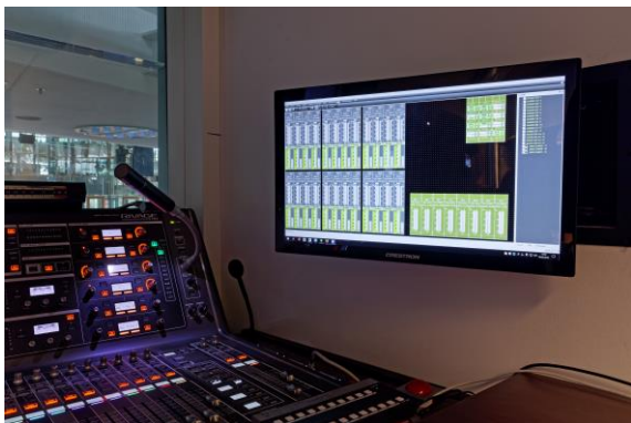
Der Wireless System Manager lässt eine umfassende Überwachung und Steuerung der Sendestrecken zu
